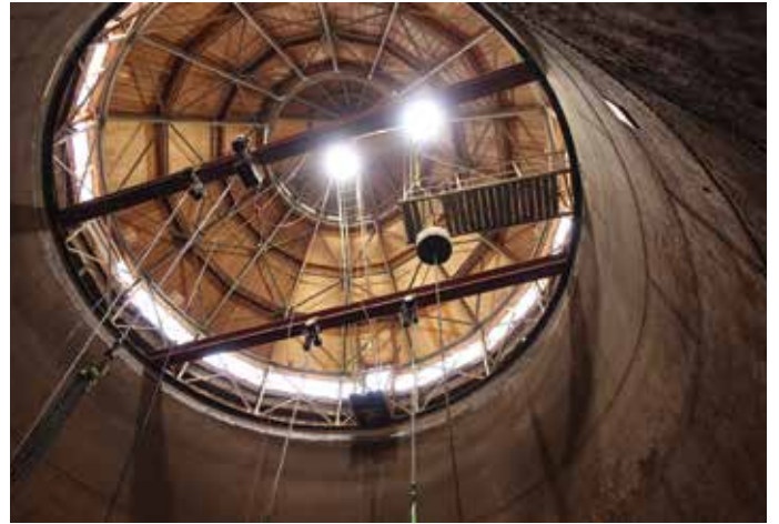
Balken met takels.
