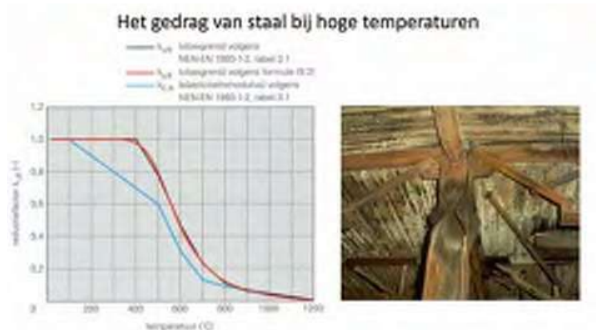
Figuur 1. Gedrag van materiaal en constructie bij brand.
