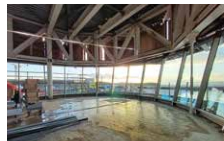
6. De staalconstructie is geknikt...
