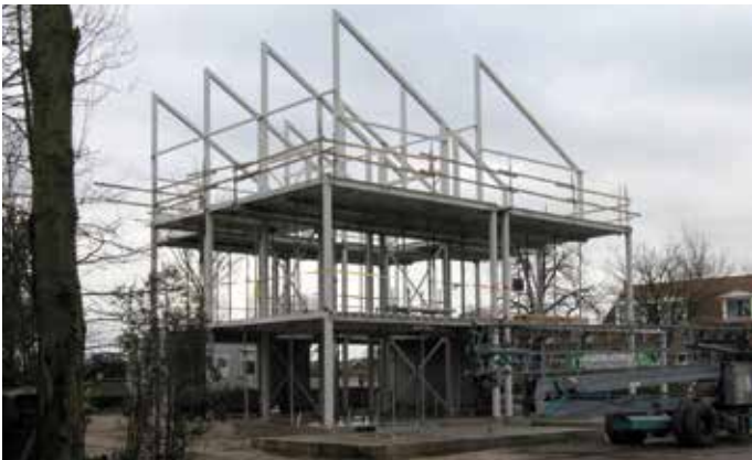
Vier portalen met momentvaste knopen. In langsricting is de constructie stijf door kruisen in de wanden langs de trap.
