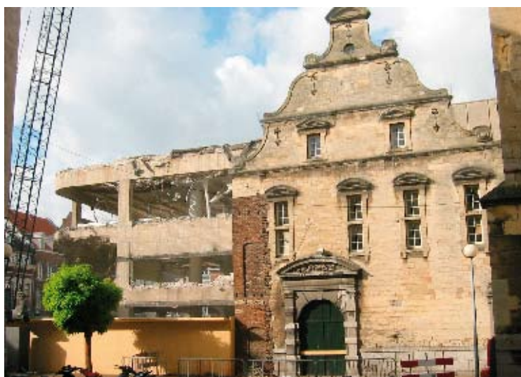
6 | Het pand Pico Bello met op de achtergrond de sloop van Entre Deux in volle gang
