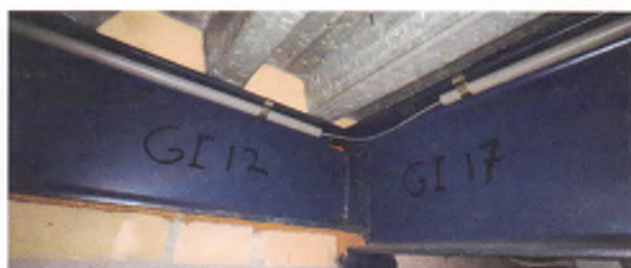
Onder: nummering van de profielen is handig in verband met de montage (foto: IMd Raadgevende Ingenieurs).
